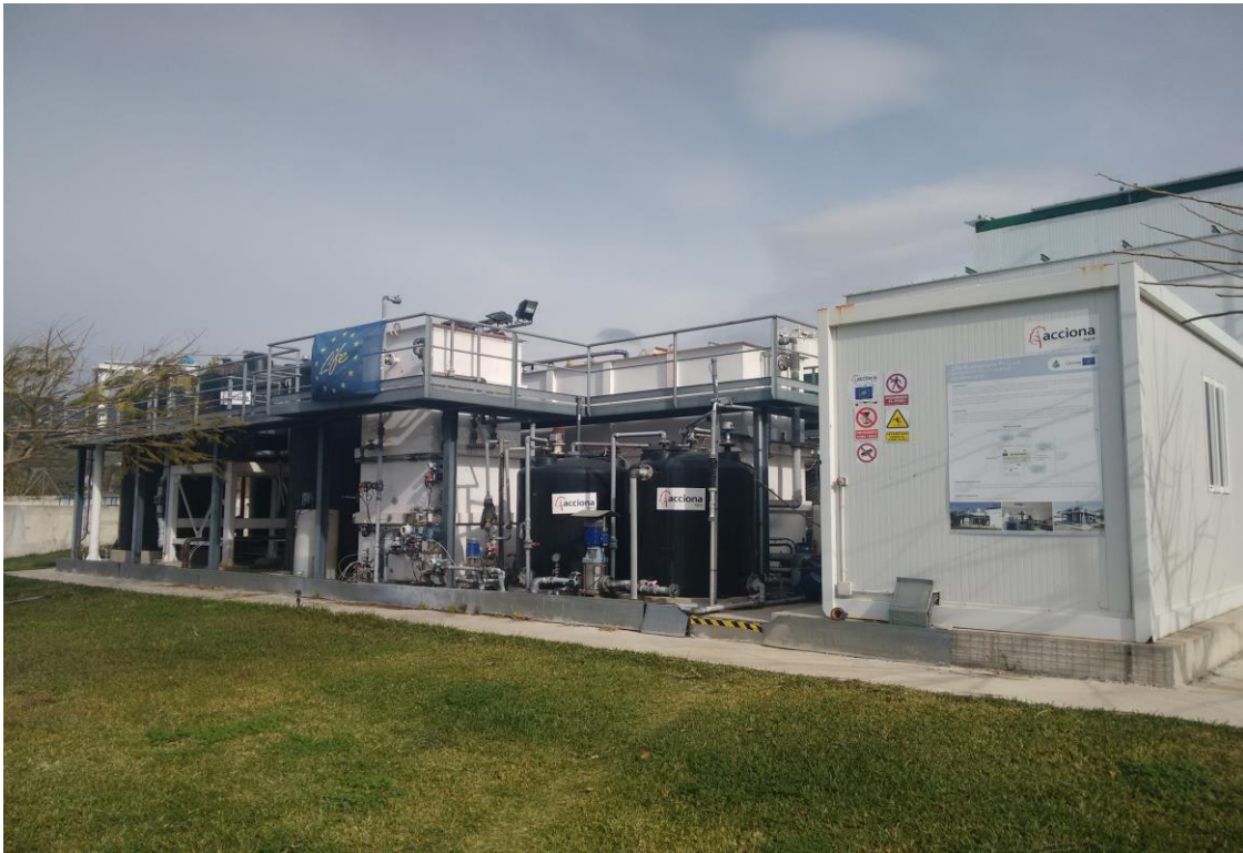
Fig. 2. Vista de la planta de demostración.
